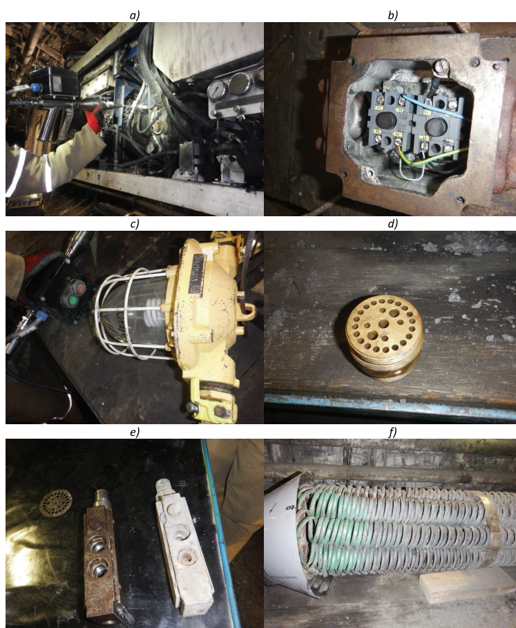
Rys. 9. Czyszczone urządzenia dołowe Fig. 9. Cleaned underground equipment
